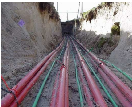
Figuur 4.3: Kabels en leidingen
