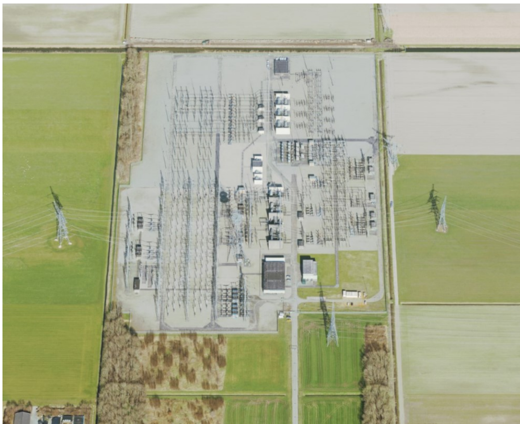
Figuur 2.4 Referentiebeeld 150-380 kV hoogspanningsstation
