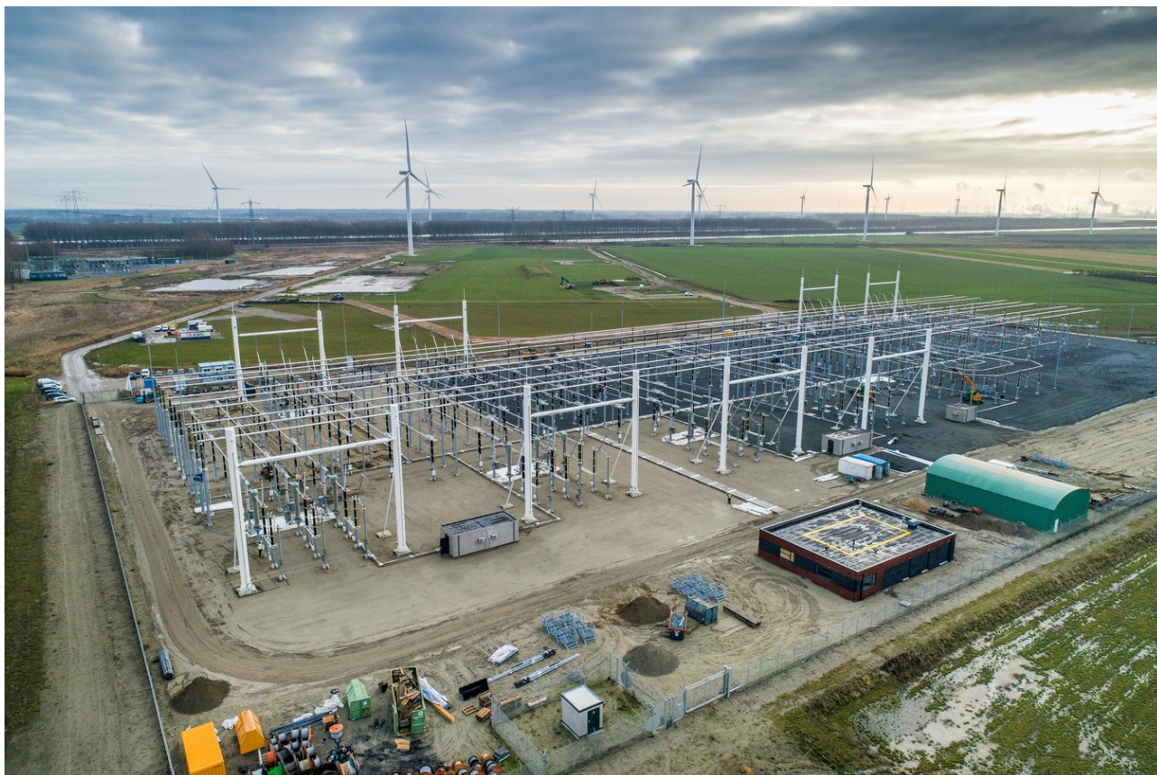
Figuur 7.1 Het in 2019 in gebruik genomen 380 kV-station Rilland, in Zeeland (bron: TenneT)
