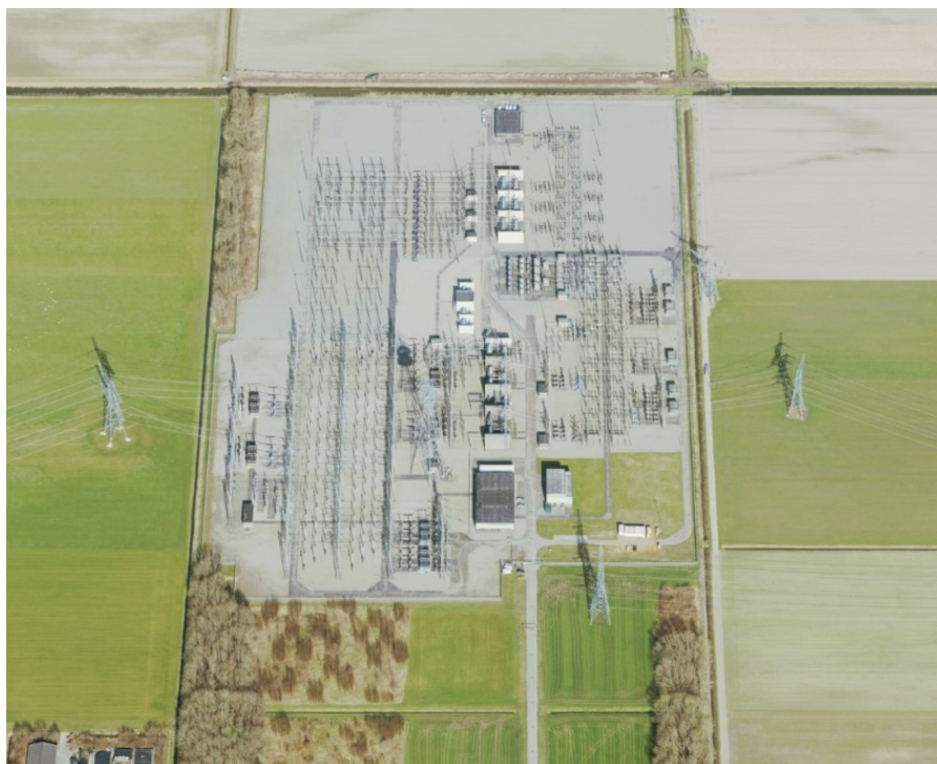
Figuur 2.5 Hoogspanningsstation Ens
