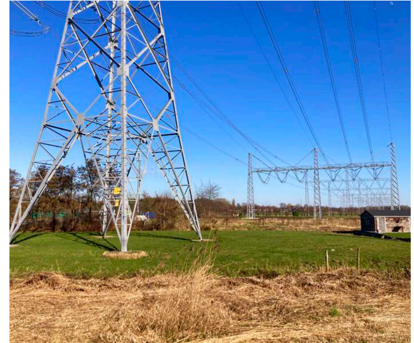
Overgang van verschillende masttypen; een Donaumast (links) gaat bij de bestaande 380 kV lijn tussen Diemen - Ens over in een portaalmast (rechts)
