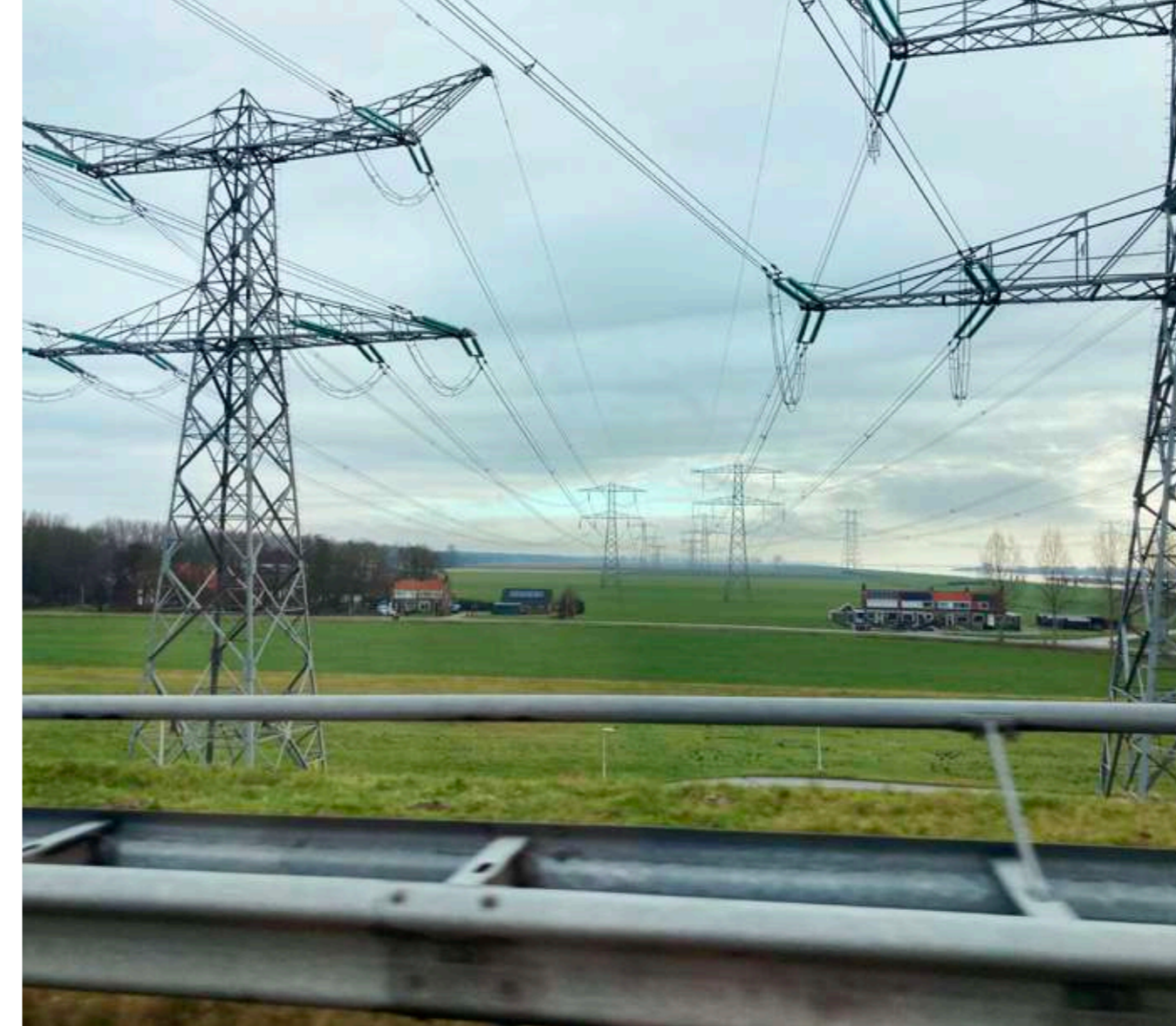
Op plekken nabij onderstations zoals bij onderstation Ens, neemt het aantal hoogspanningsmasten toe
