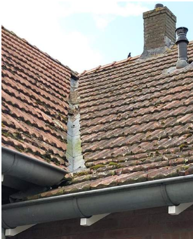
Figuur 3.7 Voorbeeld van aangetroffen spreeuwennesten onder het dak op erf 9 welke bereikbaar zijn via de kilgoten. Foto: Ecogroen.
