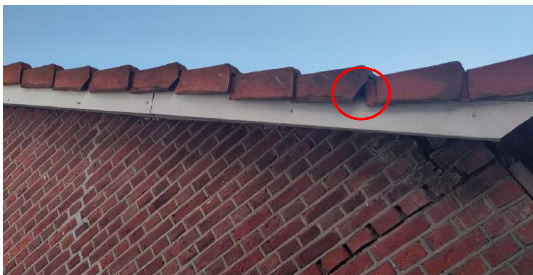
Figuur 3.1 Invlieglocatie gewone dwergvleermuis op erf 5: opening bij dakpannen (rood omcirkeld). Foto: Ecogroen.
