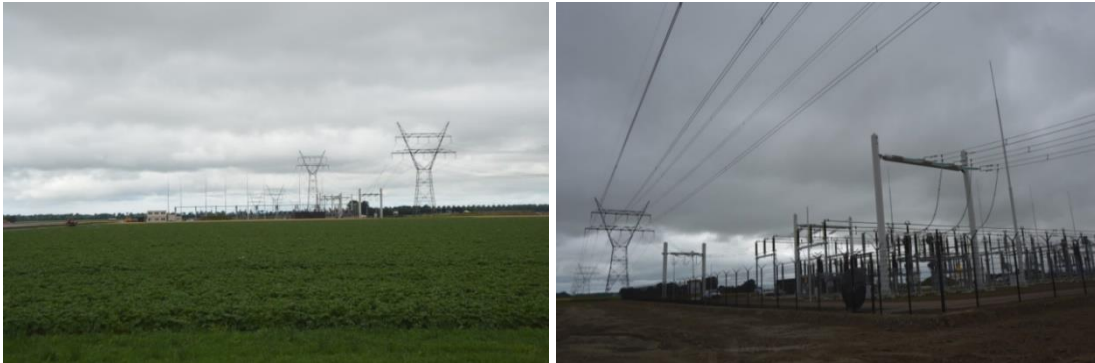
Figuur 5.7 Zicht op een hoogspanningsstation nabij Dronten, links op circa 450 meter, rechts op circa 15 meter afstand
