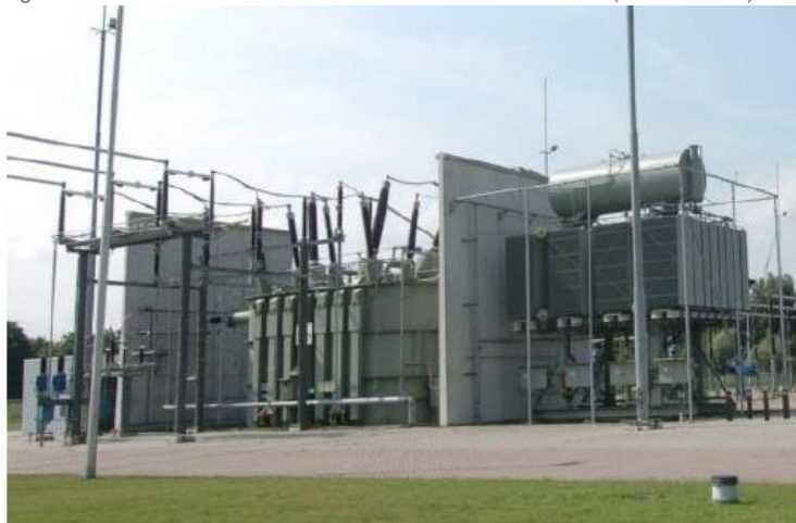
Figuur 5.2 Voorbeeld transformator in een transformatorcel (scherfmuren)
