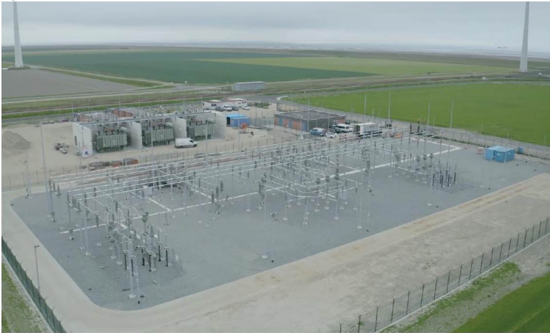
Figuur 4.6 Voorbeeld HS-station
