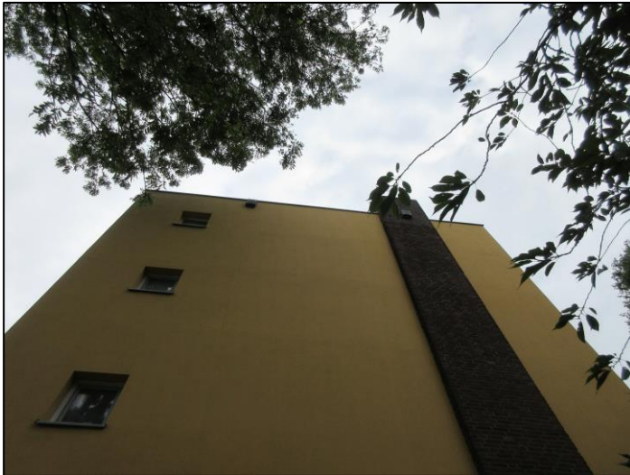
Figuur 2.5a. Vleermuiskasten aan de kapse kanten van de appartementencomplexen aan het Ruimzicht. Bron: Antea Group, 2023.
