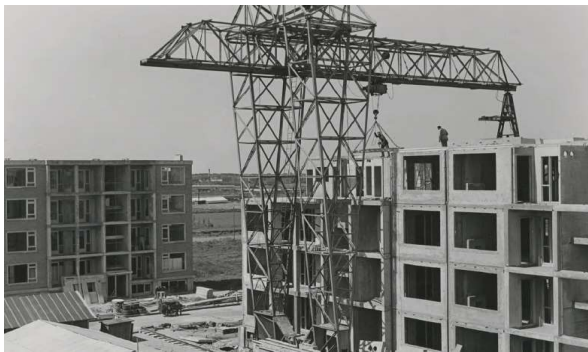
Woningen van de Dreven in aanbouw. (bron: onderzoek toekomstvastheid De Dreven | systeem Rottinghuis)
