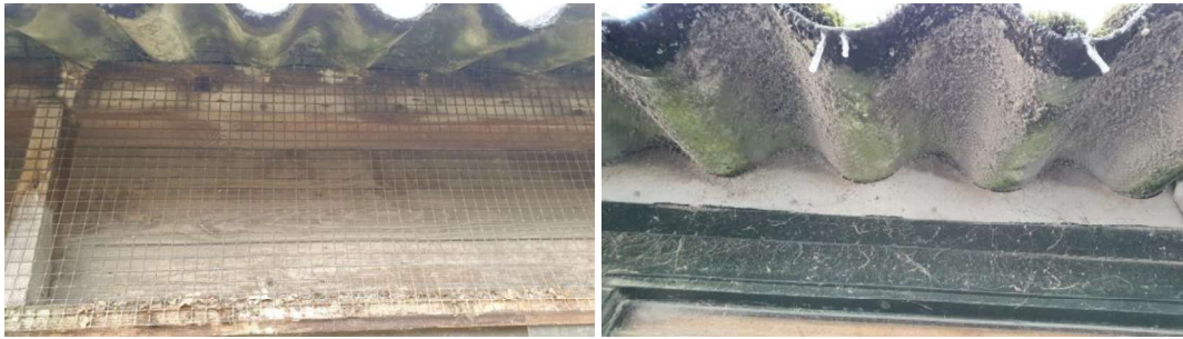
Figuur 4.4.1. Door de aanwezigheid van vogelschroot kunnen huismussen, gierzwaluwen of steenuilen de ruimte tussen het dak en dakbeschot niet bereiken.
