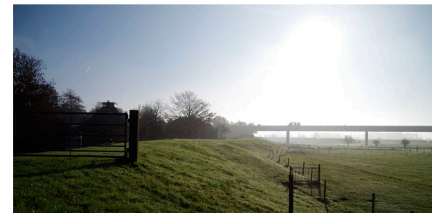
Ontoegankelijke dijk, verpacht aan agrariër, dijk slingert om historische IJsselhoeve heen Versterkingsopgave (piping)
