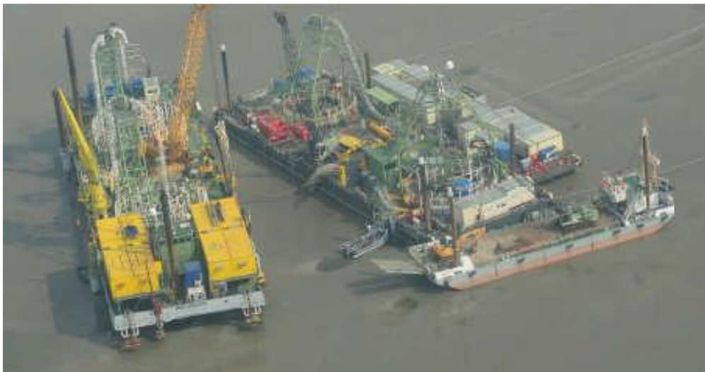
Figuur 2-3 Installatie in ondiepe zeegebieden in de kustzone
