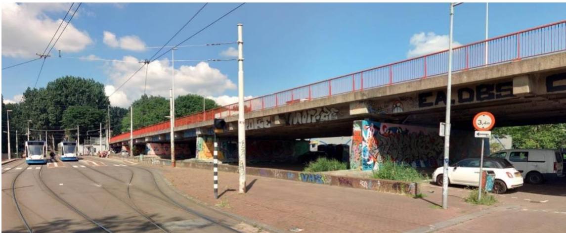
Figuur 12-9 Graffiti op pijlers van de aanbruggen van de Amsterdamse brug. Locatie: Halte Flevopark. Bron: Cyclomedia, 2022
