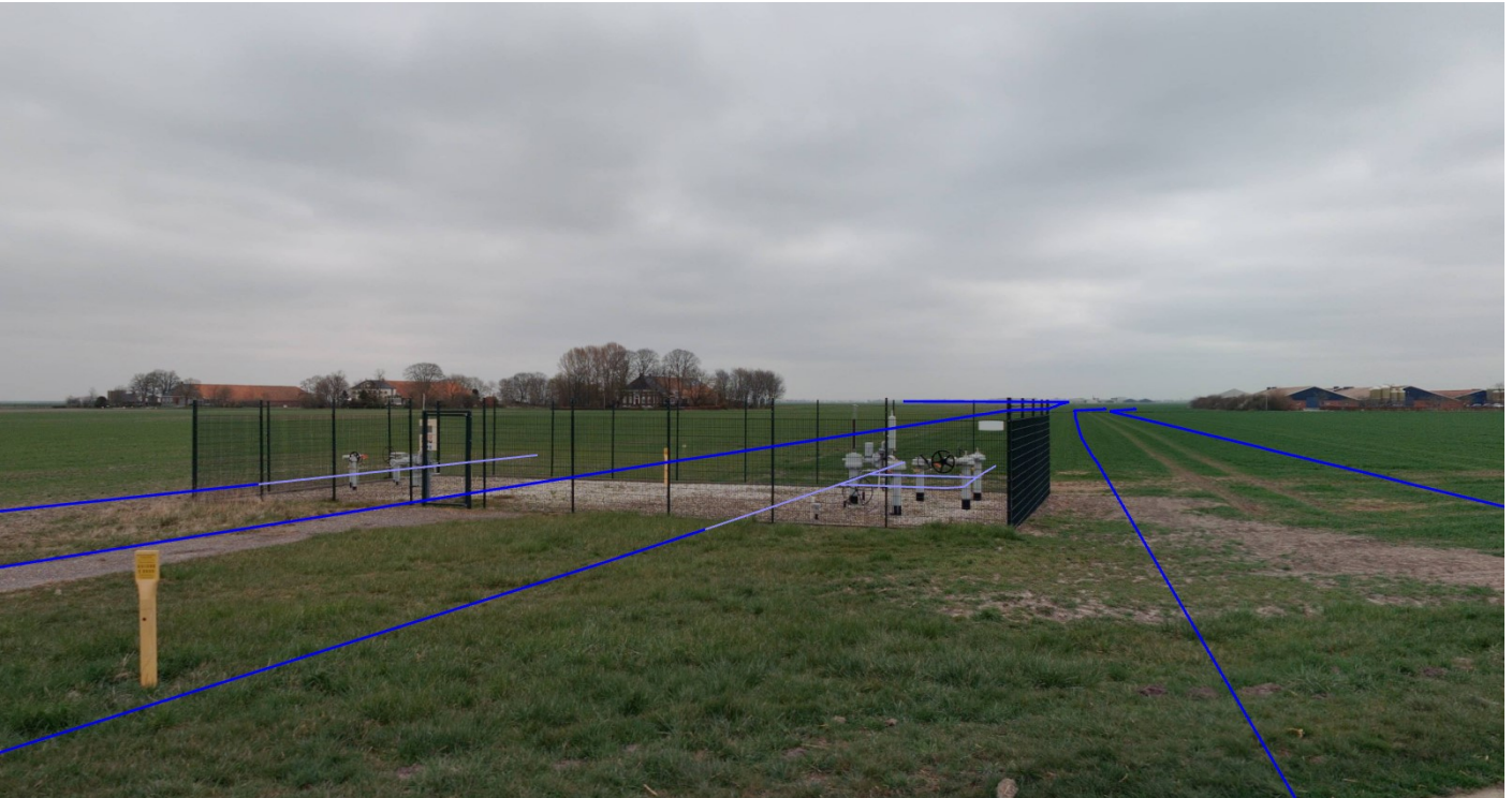
Figuur 3-1 Voorbeeld bestaande afsluiterlocatie voor aardgas S-135 Oostwold. De blauwe lijnen geven aan waar ondergronds de aardgasleidingen liggen
