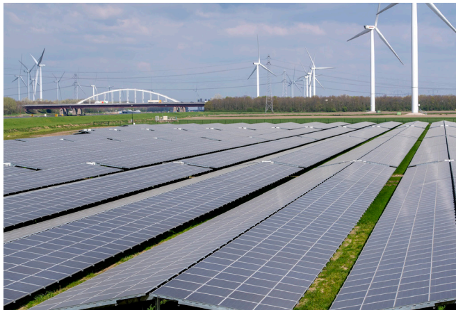
Zonnepanelen in oostwest opstelling
