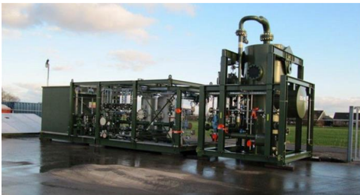
Figuur 1-7: Voorbeeld productie-installatie
