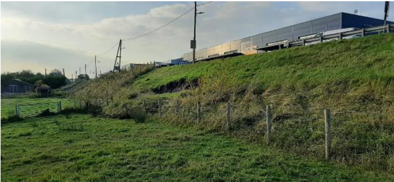
Figuur 4.1: Met enige regelmaat schuift het steile binnentalud af door water dat (door regenval) over de dijk stroomt. In dit geval kon het riool het hemelwater niet aan en liep het water over het binnentalud van de dijk en veroorzaakte een afschuiving (oktober 2021).
