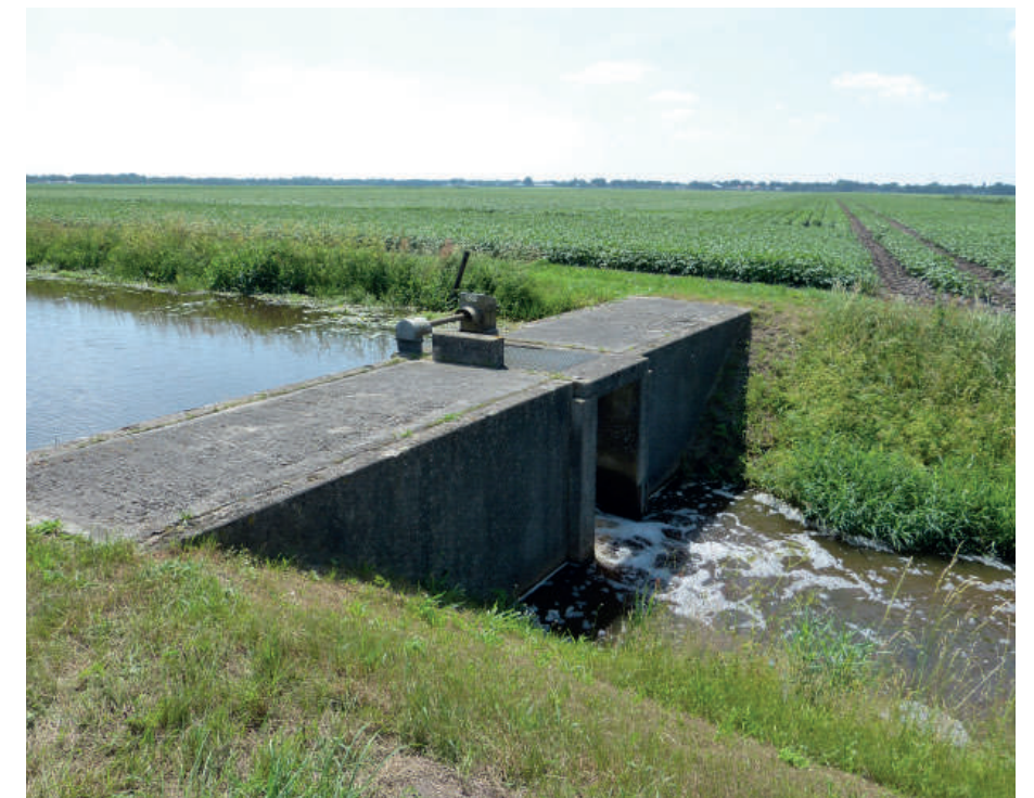
Stuw aan de Zuiderkanaalweg: 1,2m verschil in waterpeil tussen de peilgebieden.
