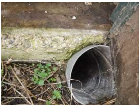
PVC mest aanzuigbuizen. Betonnen fundering/put zichtbaar.
