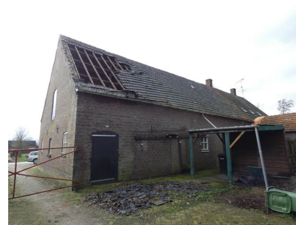
Noordgevel van het achterhuis. Het dak is bij de storm in februari zwaar beschadigd.
