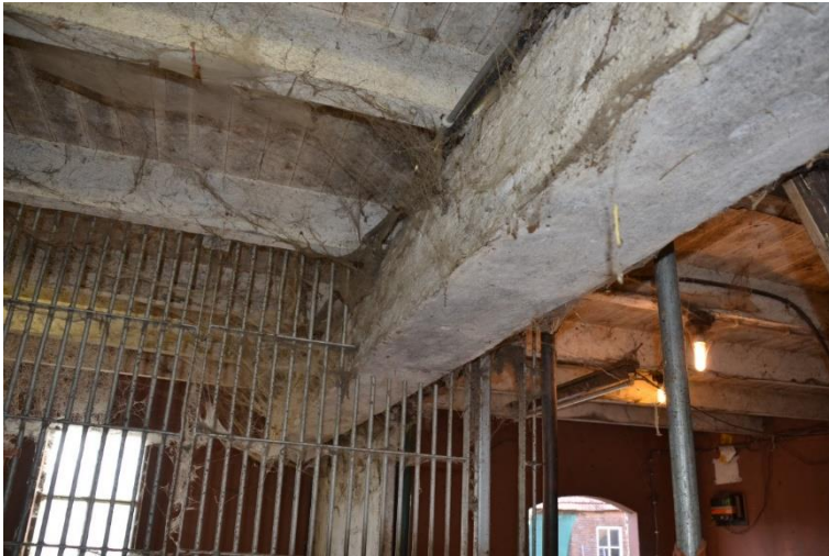
Een op de gevels afdragende moerbalk van gewapend beton met houten verdiepingvloer.
