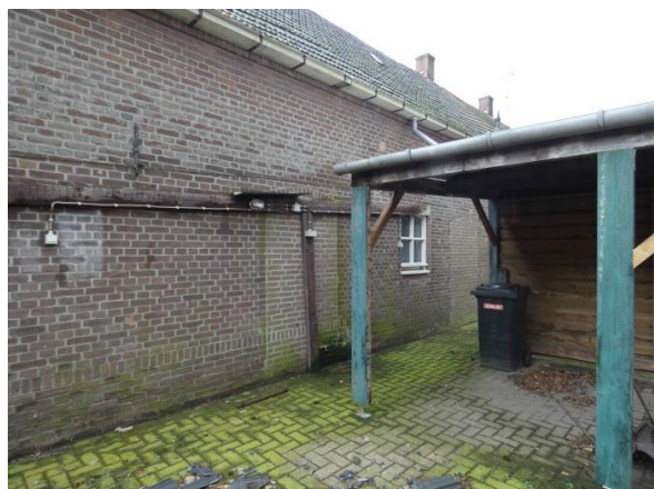
Dichtgemetselde staldeur in de achtergevel.
