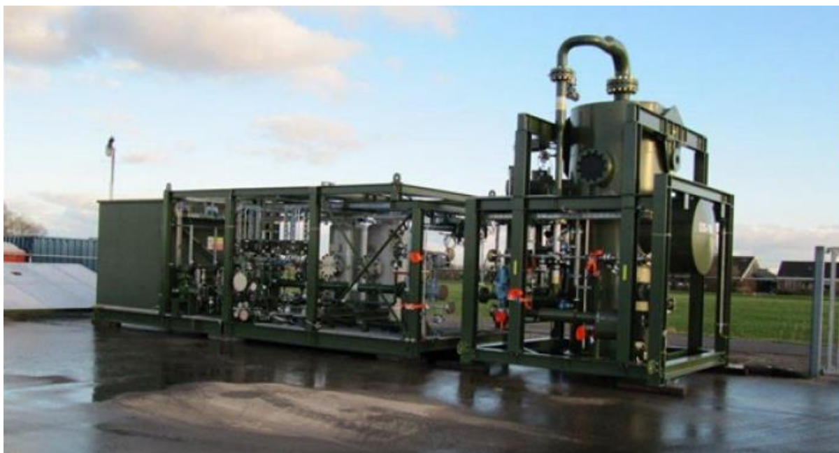
Figuur 26. Voorbeeld productie-installatie
