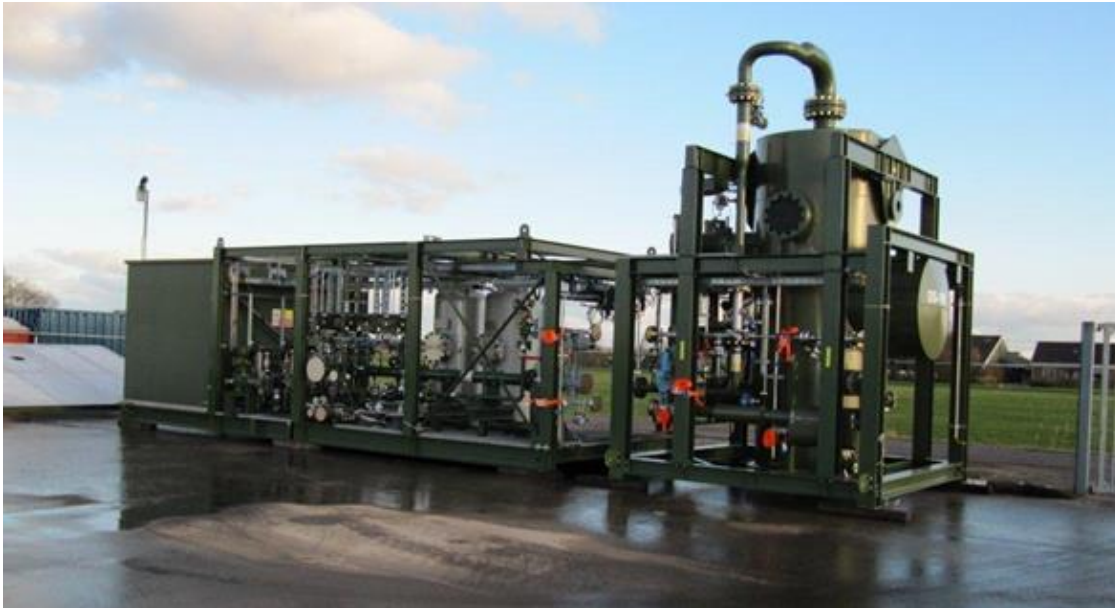
Figuur 3-11: voorbeeld van de te plaatsen productie-installatie.
