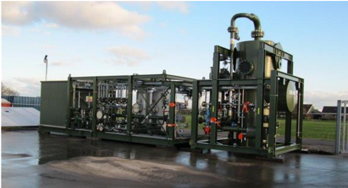
Figuur 6 voorbeeld van de te plaatsen productie-installatie.
