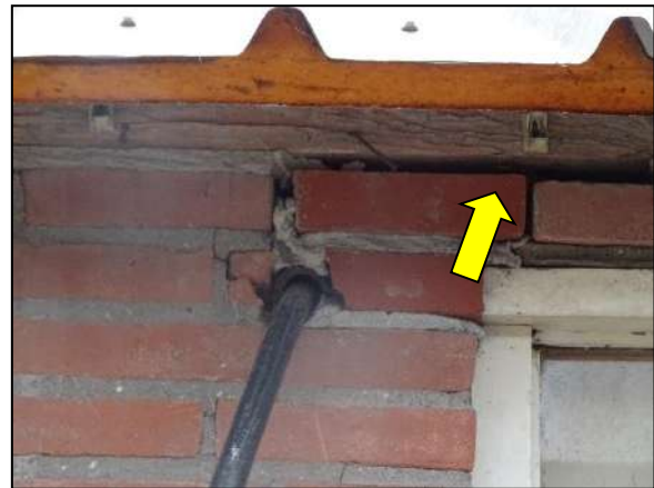
Figuur 11. Geschikte opening (gele pijl) voor vleermuizen; open voegen onder dakrand.
