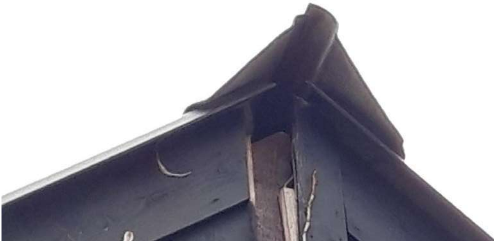
Figuur 5.5: Opening in de nok van de schuur aan de Lekdijk Oost 8
