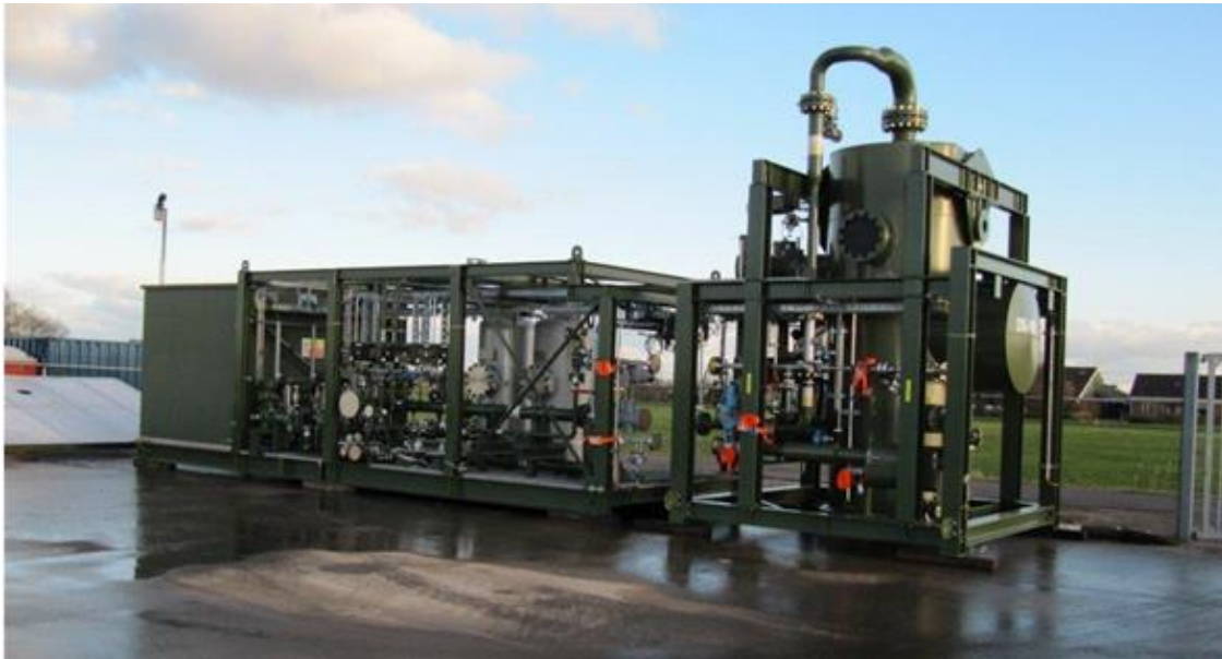
Figuur 6 voorbeeld van de te plaatsen productie-installatie.
