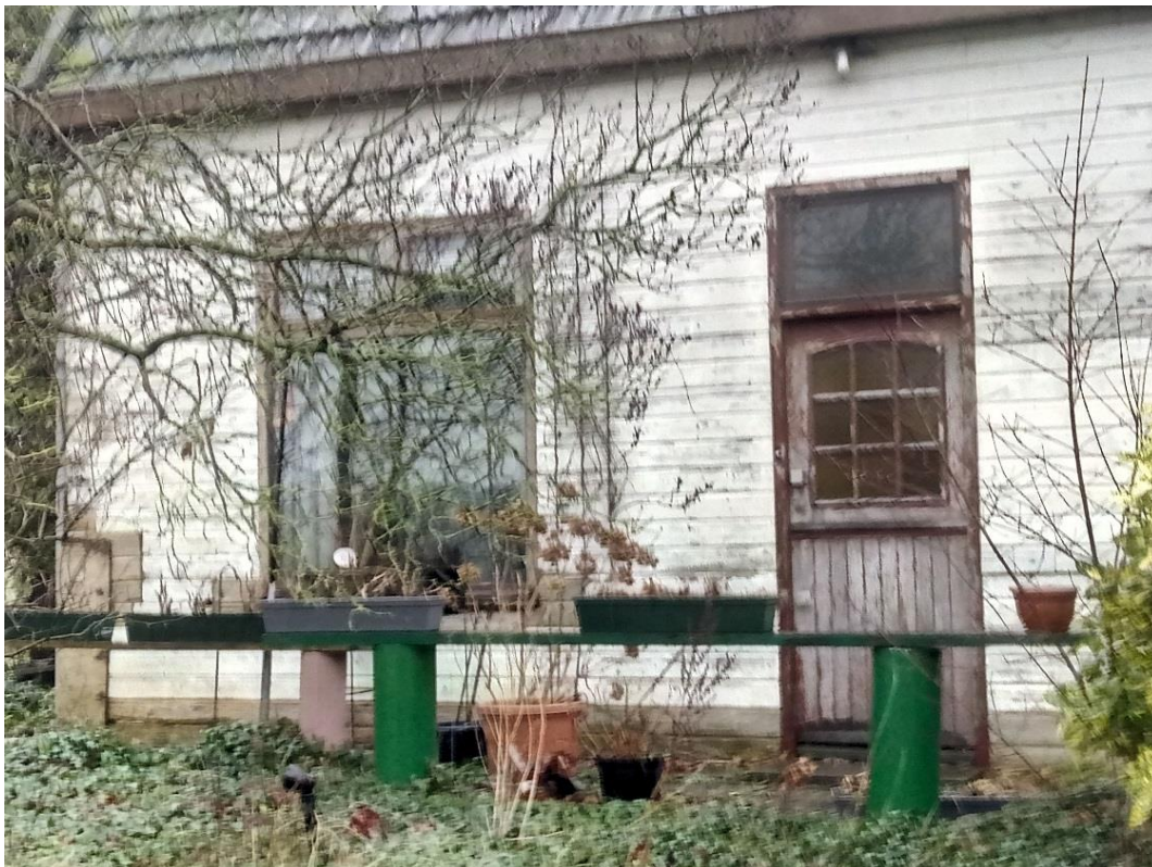
Afbeelding 10 Het houten huis aan de Lange Uitweg 85. Het schilderwerk vertoont achterstallig onderhoud. Originele houten delen zijn gerepareerd met tijdelijke materialen. Bron: Foto Vestigia 2021.
