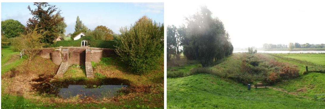
Figuur 17 Links: heul bij het voormalig stoomgemaal Wiel en Vogelzang en rechts uitwateringskanaal (voorboezem) bij de heul, beide gemeentelijk monument.
