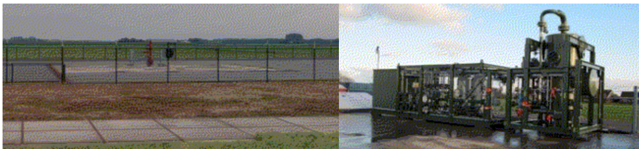
Figuur 2. Links: huidige locatie Nieuwehorne-1, zichtbaar is een afsluiter (foto september 2015), Rechts: voorbeeld van een te plaatsen productie-unit
