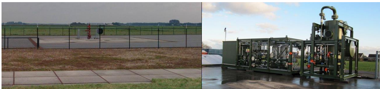
Figuur 2. Links: huidige locatie Nieuwehorne-1, zichtbaar is een afsluiter (foto september 2015), Rechts: voorbeeld van een te plaatsen productie-unit
