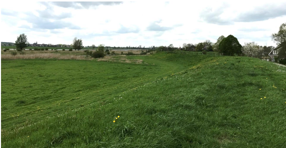
Afbeelding 5.27 Blik op de dijk en de uiterwaarden in deeltraject 13.1, richting het noorden
