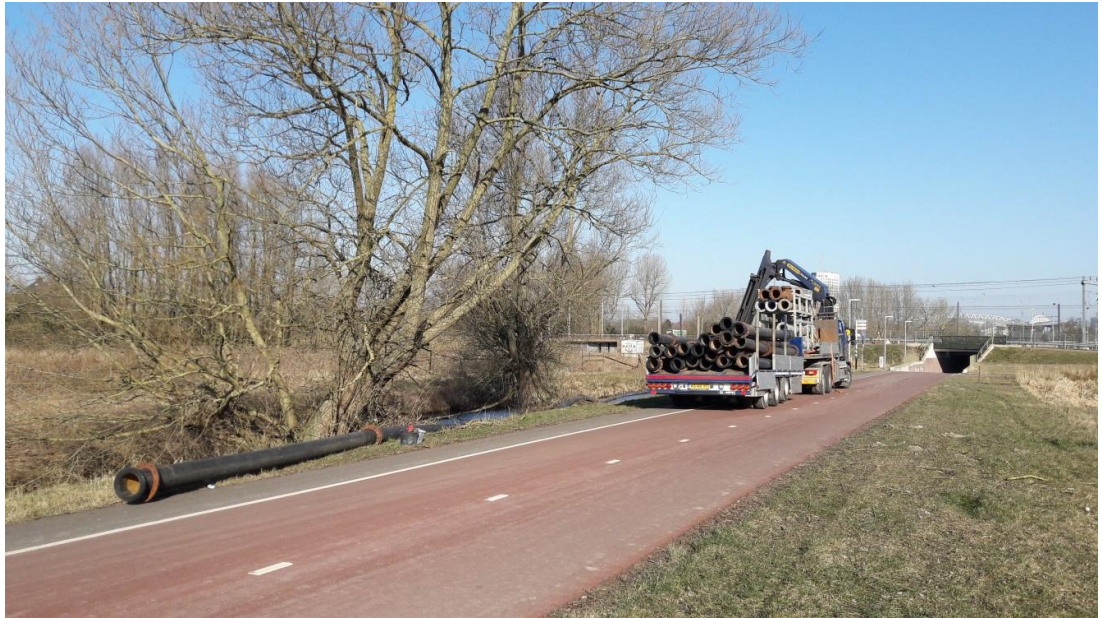
Figuur 12.6 Aanvoer en aanleg van de HDPE-pijpdelen voor de retourleiding langs fietspad en sloot
