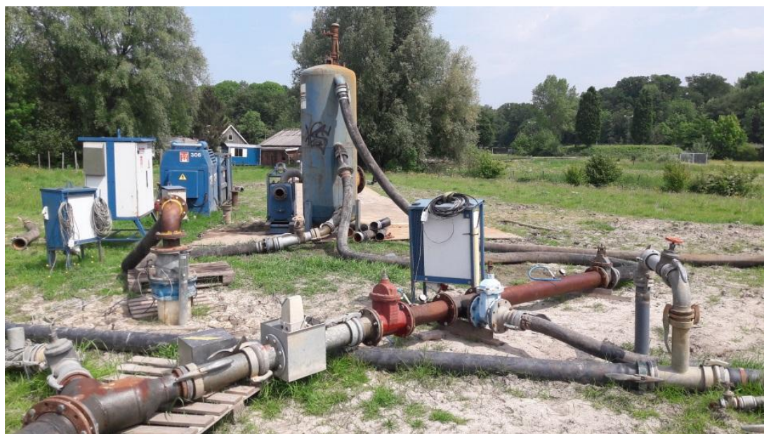
Figuur 12.10 Ontgassingsvat bij RP3, onderin afvoer naar retourput, midden invoer vanuit retourleiding, aansluiting boven spuileiding, kraan ten behoeve van ontluchting met klein fontein, hoogste opvoerleiding op het vat is de overdrukbeveiliging
