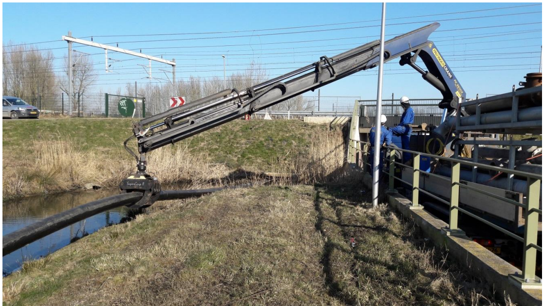
Figuur 12.7 Doorvoer van de retourleiding door de duiker onder de spoorlijn Utrecht - Arnhem
