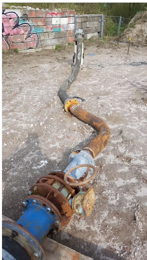
Figuur 12.2 Pompput 2 met afvoerleiding en afsluiter
