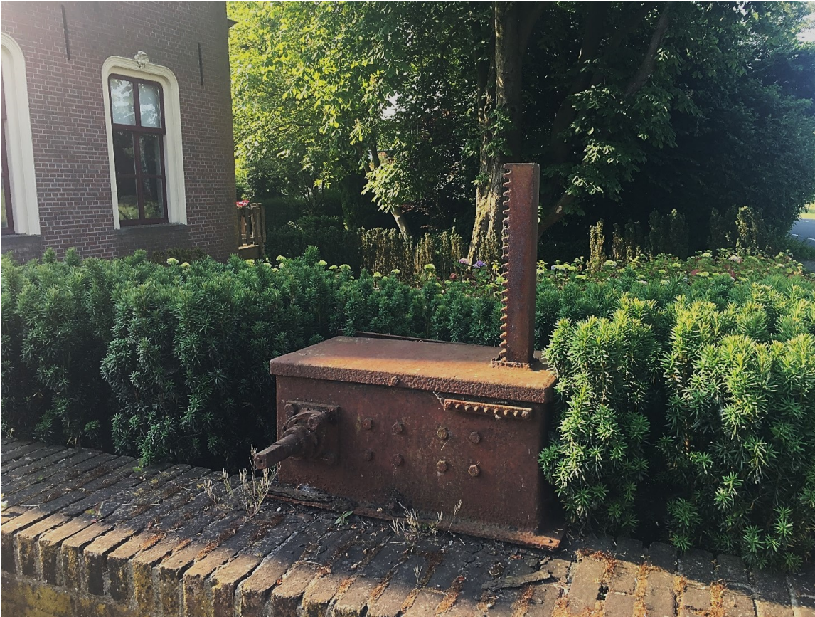
Figuur 43. Draaimechanisme van de duikersluis in de Hoge Vaart naast de Winterdijk (Arcadis).
