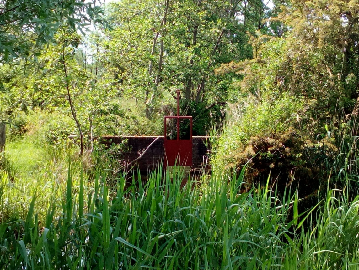
Figuur 41. Klepsluisje uit het begin van de 20e eeuw op Labbegat 3 (Arcadis).
