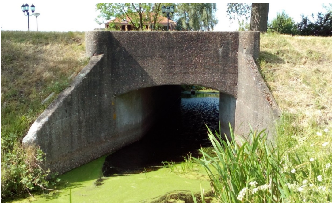
Figuur 13. De heul in de Winterdijk bij Labbegat 3 (Arcadis).
