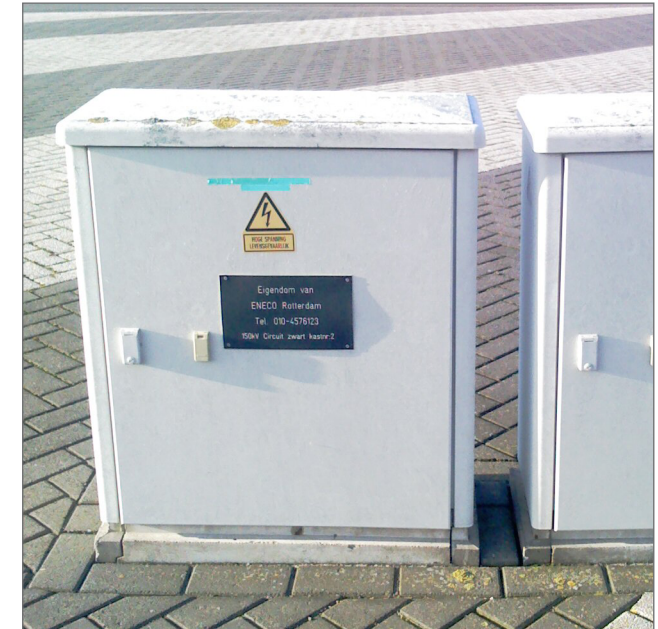
fig. 4 Voorbeeld van een cross-bondingkast
