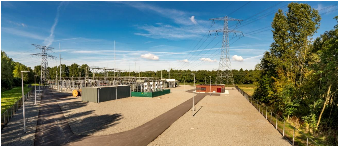
Afbeelding 6.9 Referentiebeeld van een bestaand transformatorstation
