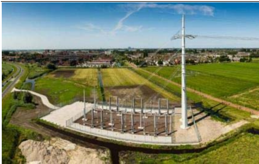
Figuur 2.10 Opstijppunt Pijnacker langs de N470 (richting hoogspanningsstation Bleiswijk)
