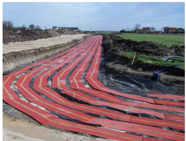
Figuur 10 kabelbed 380 kV
