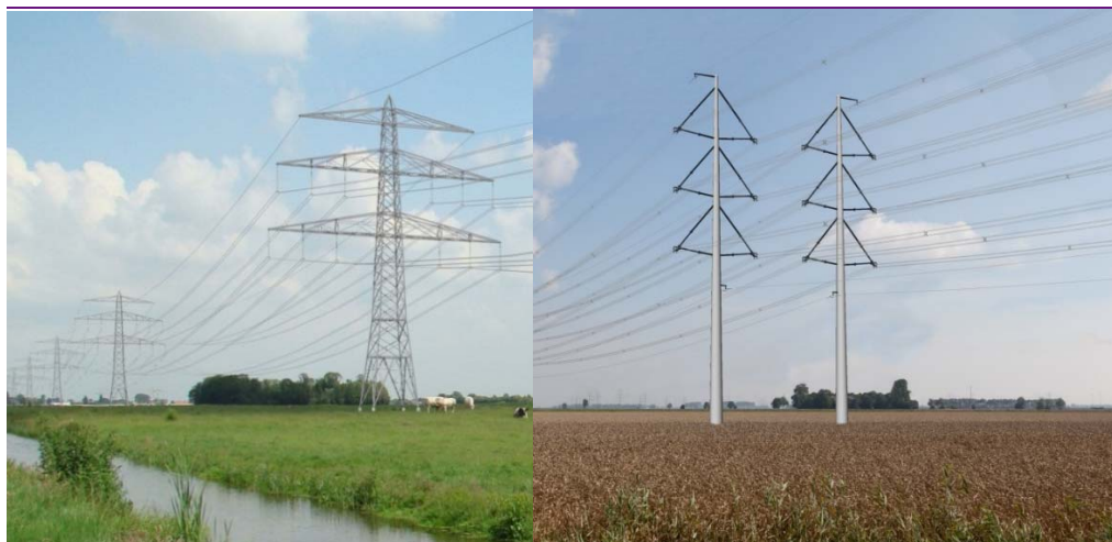
Figuur 2.3 Vakwerkmast (links) en wintrackmast (rechts)
