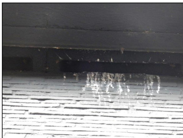
Figuur 43. Openingen bovenin het gebouw van de Hubo. Door de uitwerpselen naar verwachting in gebruik door spreeuwen.
