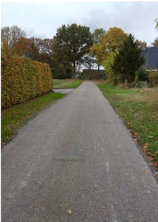
Figuur 10: Beeld van de huidige situatie van het wegdek van de Groesbaan
