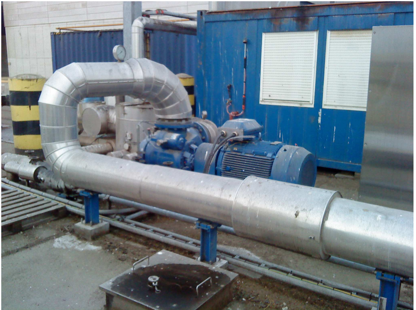
R:\Proj-P\8-5091 OOC Vergunning BTO\geluid\olieoverslag pomp\DSC00532.jpg
