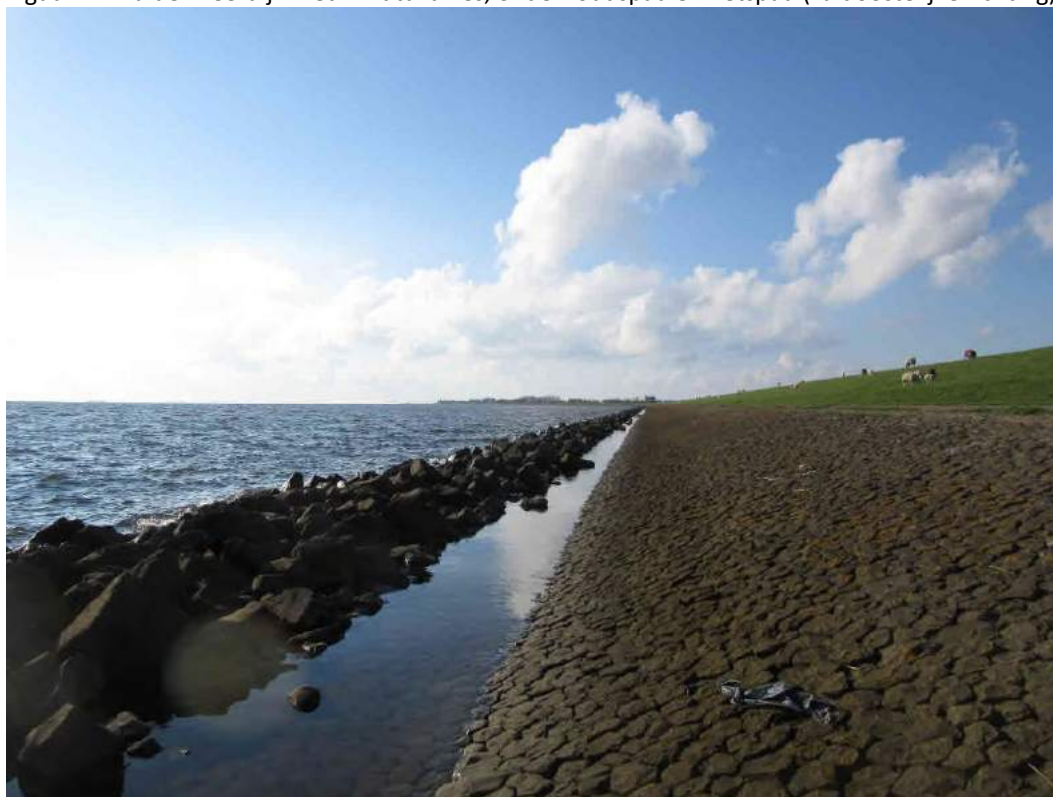
Figuur 4.3 Steenbestorting Zuidermeerdijk (noordwestelijke richting)
