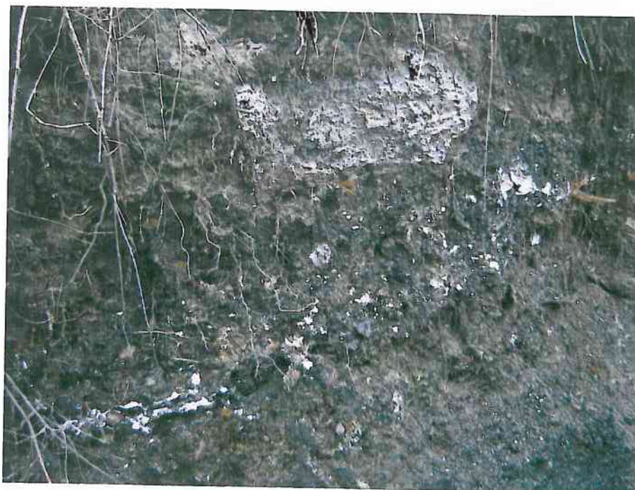
Plaatselijk is de stortplaats door rijsporen ingesleten tot in het stortmateriaal
