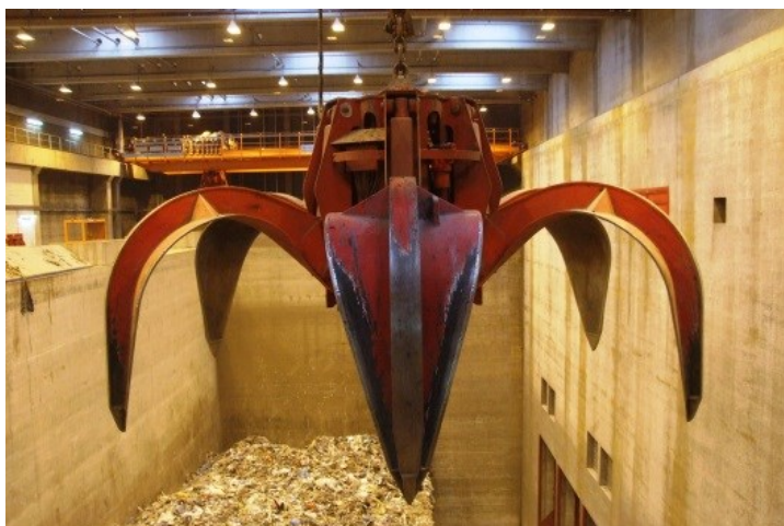
Figuur 8 Bunker met grijperkraan
